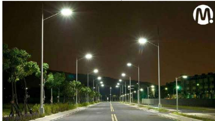
Modernización del alumbrado público de Villavicencio
